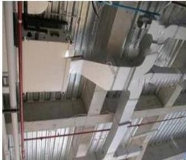
Gambar 12. Instalasi AC Sentral pada FCU
