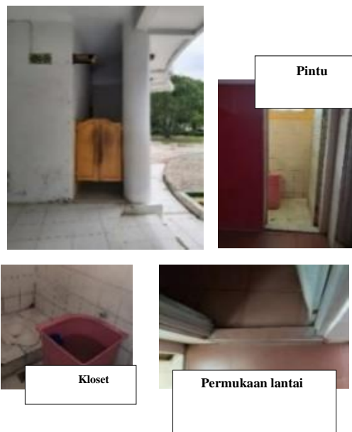
Gambar 10. Kondisi aksesibilitas toilet umum (Sumber: dokumentasi pribadi, 2021)
