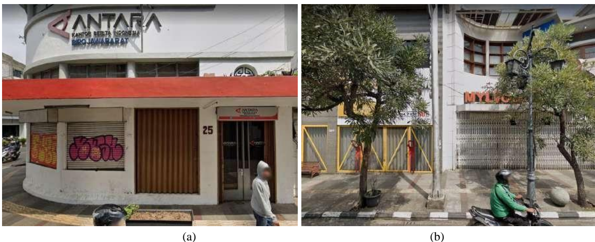
Gambar 9. Pintu Lipat Besi (a) Dicoreti Grafiti, (b) Berongga Sumber: Google Street View, 2019
