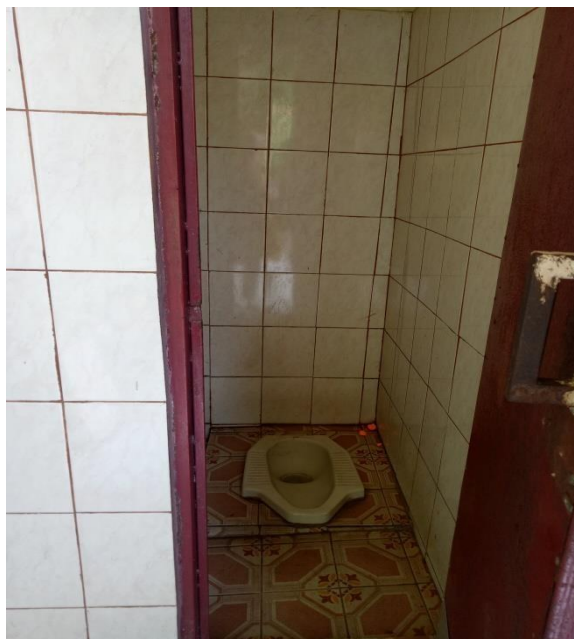
Gambar 5. Toilet tanpa Tersedia Air Bersih
